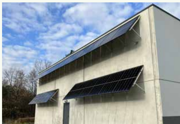
Gevelmontage van zonnepanelen in Verviers
