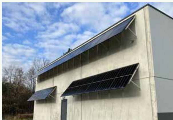
Panneaux solaires en façade à Verviers
