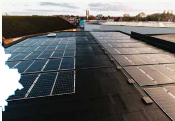
Panneaux solaires flexibles légers sur le toit de Kuurne
